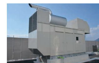
72時間対応の大型非常用発電機（宮城物流センター）
