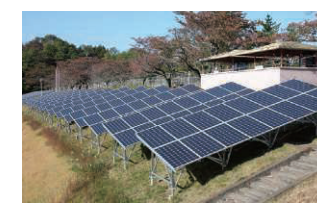
環境にも配慮したソーラーパネル（宮城物流センター）
