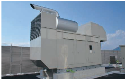
震災時の長期停電を経験し宮城物流センターに配備されている、72時間対応の大型非常用発電機
